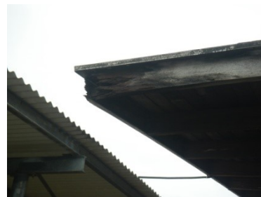
Pourriture du bois en raison d'une infiltration d'eau
