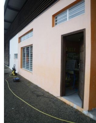
Faible protection solaire à l'Est
