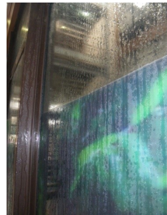
Condensation sur les parois vitrées du hall
