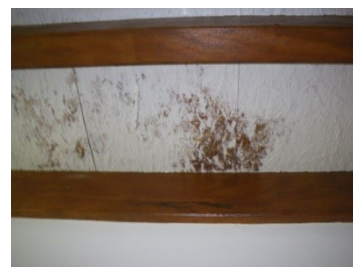
Moisissures en faux plafond
