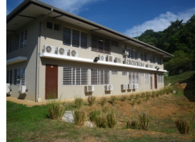
Manque de protections solaires et groupes de climatisation
