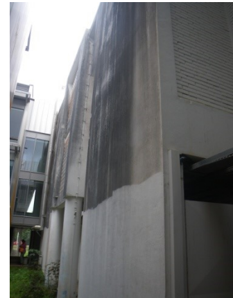
Difficulté d'entretien car la cour est inaccessible pour une nacelle
