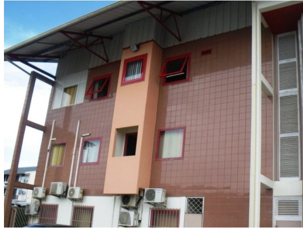
Fenêtres de locaux climatisés ouvertes et multiplication des splits en façade.
