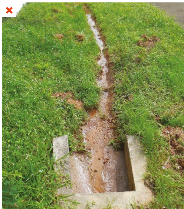
Ouvrage hydraulique sous dimensionné à proximité d'un bâtiment peu surélevé ©AQC
