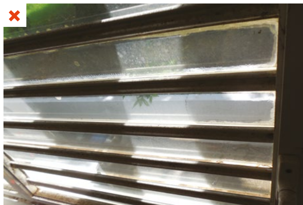
Jalousies exposées : plastiques, films solaires, joints et mécanismes altérés. ©AQC
