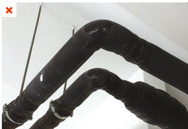
Réseau d'eau glacée présentant des traces de condensation. ©AQC
