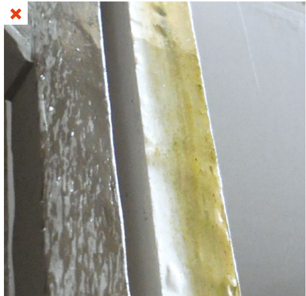
Absence de protection d'une façade exposée à la pluie provoquant la dégradation accélérée des matériaux de structure. ©AQC
