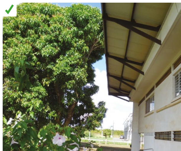
Taille effectuée afin de limiter le contact immédiat de la ramure avec la toiture. ©AQC
