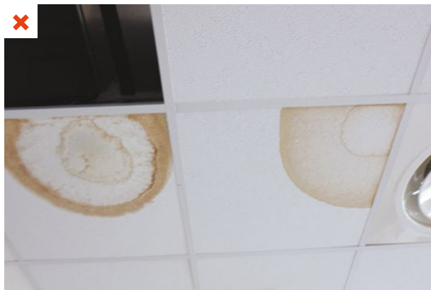
Traces de condensation dues à l'absence d'isolation des réseaux de froid. ©AQC
