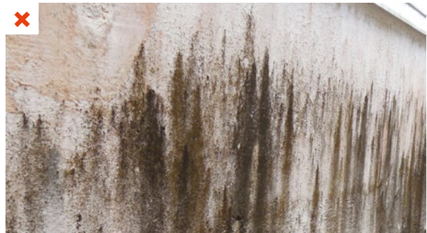
Absence de débord de toiture et de protection à la pluie provoquant l'apparition de moisissures sur la façade. ©AQC
