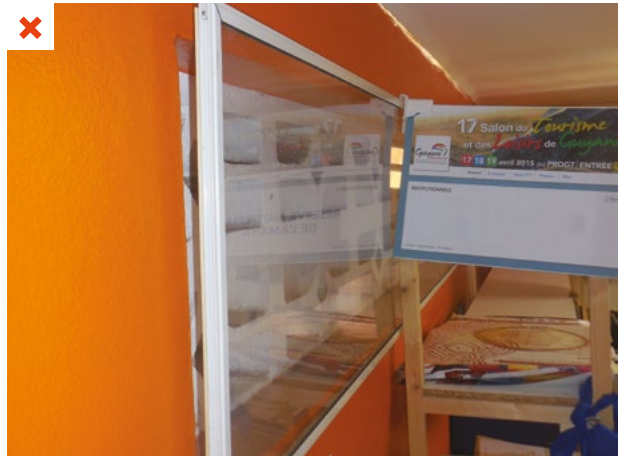
Lors de la réhabilitation la climatisation a été installée dans cette pièce. Une menuiserie à faible résistance thermique a été installée et posée de façon non affleurante. Les pertes thermiques sont importantes. ©AQC
