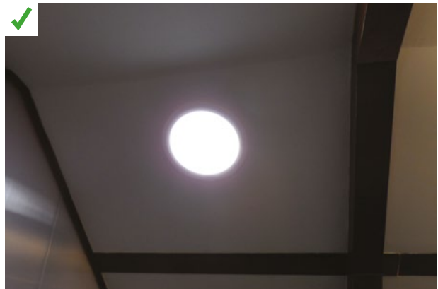
Canon à lumière naturelle dans un bureau installé dans les combles. ©AQC
