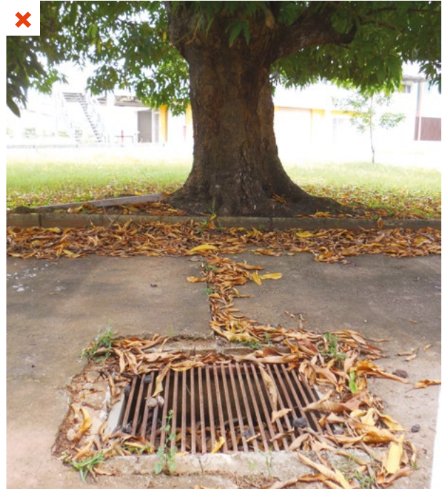
Manguiers à proximité du réseau d'évacuation des eaux pluviales. ©AQC
