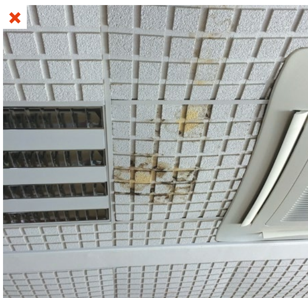
Développement de moisissures sur les faux plafonds. ©AQC
