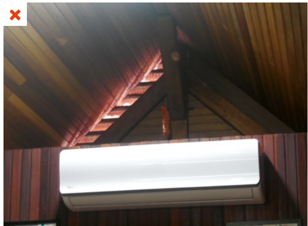
Jours importants présents dans l'une des parois d'une salle climatisée, laissant s'échapper l'air rafraîchi. ©AQC
