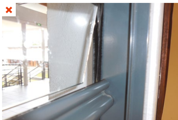
L'usure du mécanisme entraîne une fermeture incomplète des lames des jalousies : défaut d'étanchéité à l'eau en cas de pluie chassée par le vent. ©AQC
