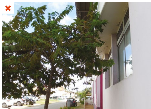
Mauvaise implantation et croissance non maîtrisée menaçant à terme la façade du bâtiment. ©AQC
